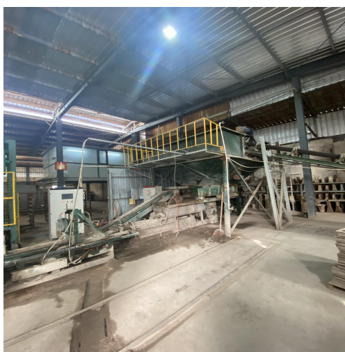
原料搅拌车间
