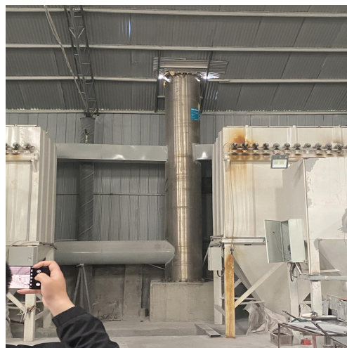
精加工车间总排气筒
